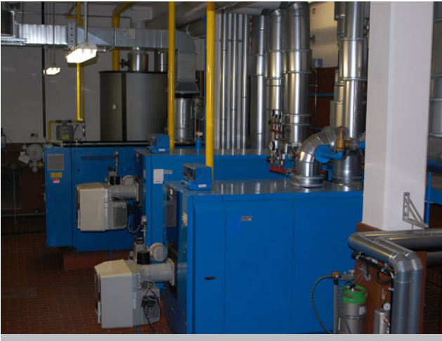
Abb. 6: Klimaschutz bedeutet in Fulda auch den Einsatz moderner und effizienter Anlagentechnik in kommunalen Liegenschaften
